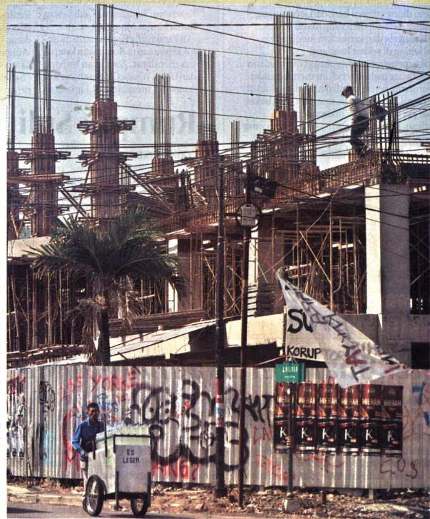
SEMRAWUT: Keberadaan kabel fiber optic yang tidak tertata. Penataan kabel ini didorong dengan memanfaatkan PJU.
