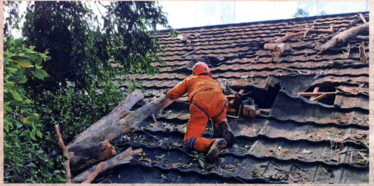
EVAKUASI - Proses evakuasi sempalan pohon yang menimpa atap bangunan Jogja Gallery, di Jalan Pekapalan, Kemantren Gondomanan, Kota Yogya, Minggu (14/6). DOK: BPBD KOTA YOGYA
