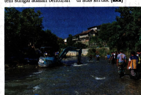
KERUK - Alat berat diturunkan untuk menormalisasi aliran Sungai Winongo di kawasan Bendung Tanjung, Kemantren Wirobrajan, Jumat (24/4).
