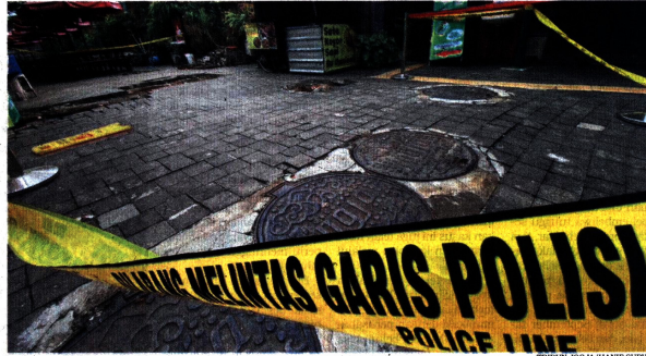
GARIS POLISI - Garis polisi dipasang di Area Kuliner Lantai Dasar Teras Maliboro 1, Yogyakarta, Senin (30/3). Pemasangan ini dilakukan menyusul insiden ledakan instalasi saluran limbah (bio-filter) yang dipicu oleh akumulasi gas metana.
