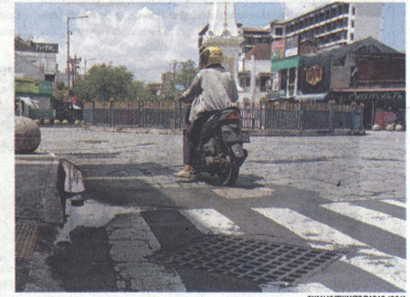
MUNCUL BAU: Kondisi saluran drainase di Perempatan Tugu pada kemarin (12/3). Di titik tersebut muncul bau tidak sedap.
