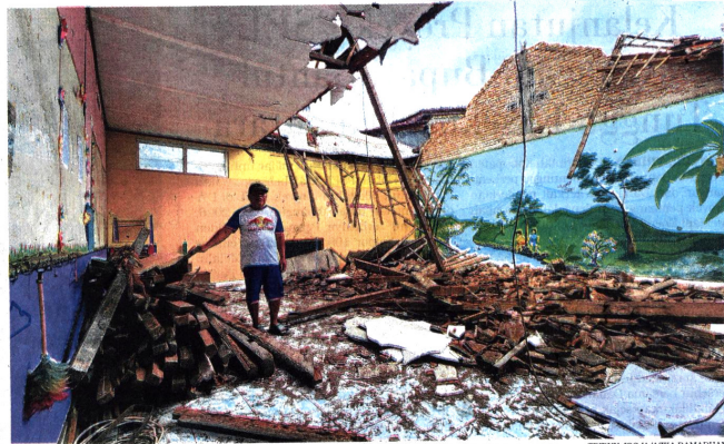
TIDAK BERATAP - Kondisi salah satu ruang kelas di TK Netral D, Kemantren Gedongtengen, Kota Yogyakarta, yang sudah tidak beratap.
