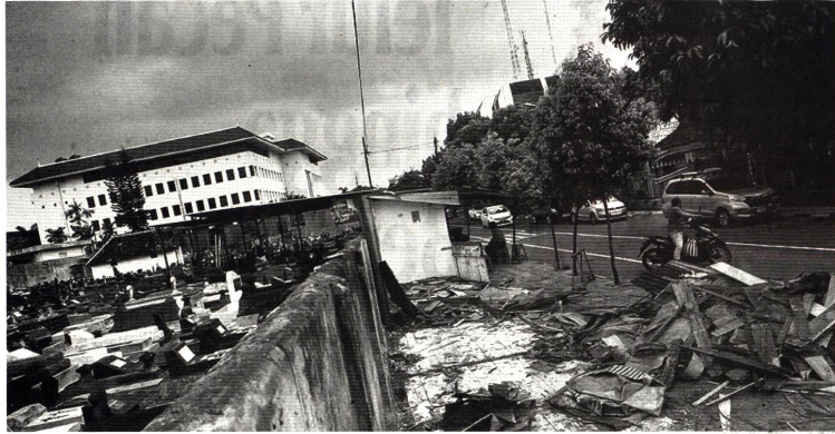
MATANG: Pengguna jalan melintas di dekat bekas bangunan lapak pedagang buku yang sudah dibongkar di Jalan Kahar Muzakir, Kota Jogja. Konsep penataan kawasan ini telah final, direncanakan trotoar menggunakan material batu andesit dan kabel fo ditata di bawah tanah.
