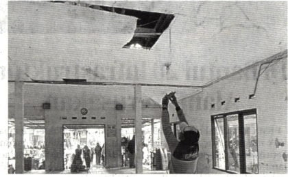
AMBROL: Kondisi atap bangunan Balai Kampung Tahunan RT 13/RW 03, Kemantren Umbulharjo, Kota Jogja yang rusak akibat gempa bumi tektonik kemarin (6/2).
