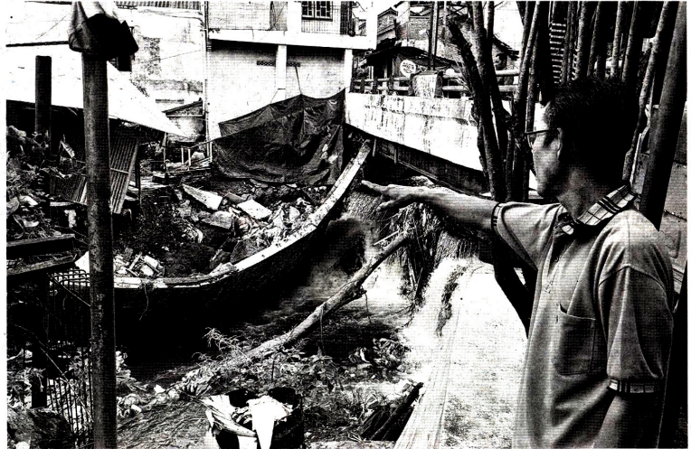
ROBOH: Warga saat menunjukkan kondisi talut Jembatan Kali Buntung, Bumijo, Jetis, Kota Jogja yang ambrol kemarin (18/1).
