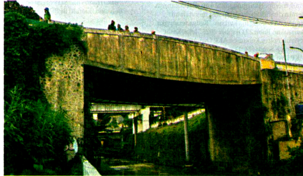
MEMPRIHATINKAN: Pekerja melintas di atas Jembatan Kewek, Kota Jogja, kemarin (24/11). DPUKPK Kota Jogja berencana membangun ulang Jembatan Kewek karena tingkat kerusakannya sudah parah.
