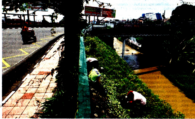
PERAWATAN: Pekerja membersihkan tanaman liar yang tumbuh di tebing yang berdekatan dengan Jembatan Kewek sisi selatan, Kota Jogja, kemarin (19/11). DPUPKP Kota Jogja berencana membangun ulang Jembatan Kewek karena tingkat kerusakannya sudah parah.
