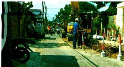
REVITALISASI - Proyek revitalisasi saluran air hujan (SAH) yang digulirkan Pemkot Yogya di Jalan Prof. Dr. Soepomo.
