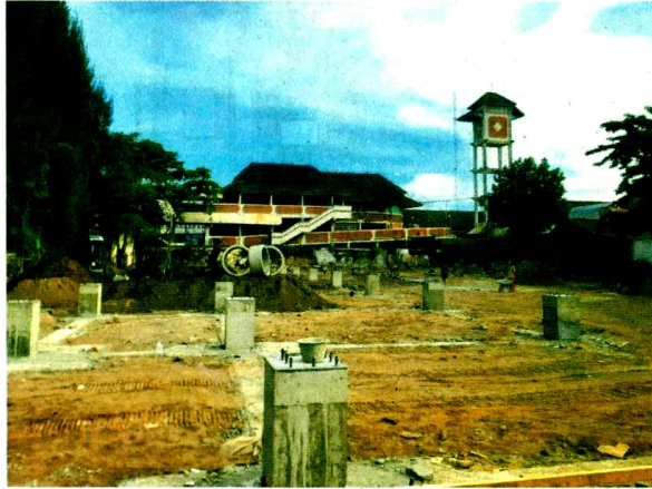
PINDAH - Proyek pemindahan konstruksi dari Lokasi Parkir Khusus ABA ke kawasan Ketandan, Kamis (17/7).
