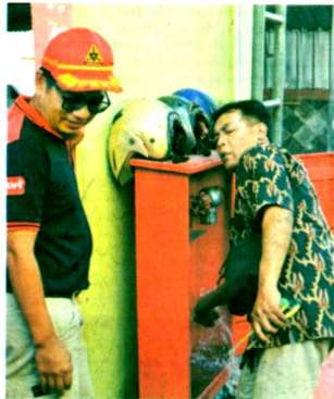
Petugas memastikan fungsi hidran di Rusunawa Cokrodirjan.
