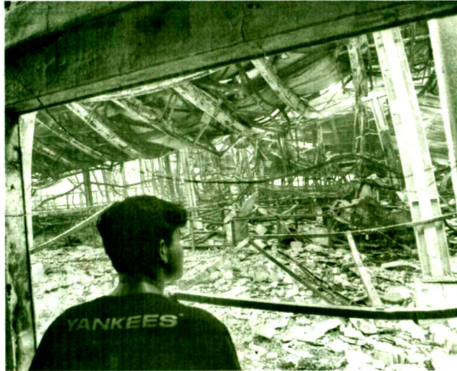
MENGAMATI: Kondisi kebakaran di dalam bangunan pabrik garmen PT Mataram Tunggal Garmen yang hangus dan porak poranda, di Balong Donoharjo Ngaglik, Sleman, Rabu (21/5).
