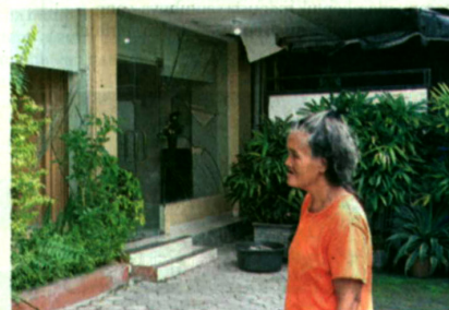
LOBBY HANCUR: Kondisi Hotel Shafira yang juga mengalami kerusakan terdampak dari ledakan SPBU Gedongtengen, kemarin (27/5).
