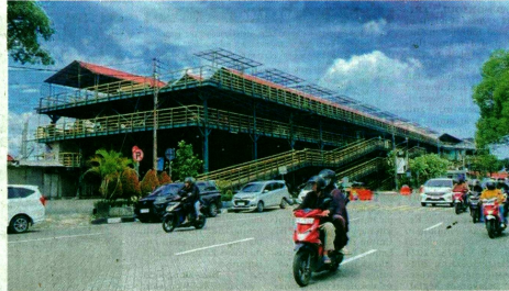
MELINTAS - Kendaraan bermotor melintas bangunan TKP Abu Bakar Ali, Kota Yogyakarta, belum lama ini.
