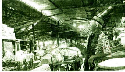
BERHARAP PERBAIKAN: Para pedagang di Pasar Legi Kotagede saat menunjukkan kondisi atap yang memprihatinkan kemarin (20/3).
