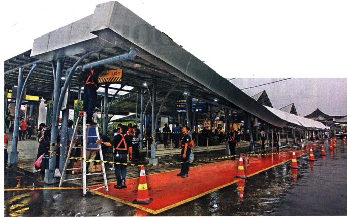
TIMPA LIMA MOBIL: Petugas menyelesaikan proses perbaikan kanopi yang roboh di area penjemputan di Stasiun Tugu, Jogja, kemarin (4/1). Atap roboh di zona penjemputan penumpang Stasiun Tugu itu darggak dari hujan lebat disertai angin kencang dan tidak ada korban jiwa dalam kejadian tersebut.
