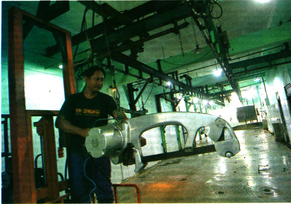
SIAP DIGUNAKAN: Petugas memeriksa kondisi mesin dan peralatan di Rumah Pemotongan Hewan (RPH) Giwangan, Kota Jogja, kemarin (14/6). RPH Giwangan melayani penyembelihan hewan kurban selama tiga hari dengan kapasitas 75 hewan setiap harinya.
