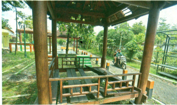
TIDAK TERAWAT: Pengguna sepeda motor saat melewati Padas Temanten di Kampung Karang, Prenggan, Kotagede, Kota Jogja yang terbengkalai. Fasilitas pendukung seperti gazebo bahkan rusak dan tidak diperbaiki.
