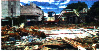
RATA TANAH - Sebuah alat berat melakukan pembongkaran ruko di Jalan Perwakilan, Minggu (22/1). Bangunan-bangunan di kawasan tersebut sudah rata dengan tanah setelah negosiasi alat antara pedagang dengan pemerintah Kota Yogyakarta.
