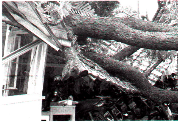
RUSAK : Pohon tumbang di jalan AM Sangaji, Cokrodiningratan, Jetis, Kota Jogja mengakibatkan kerusakan bangunan.
