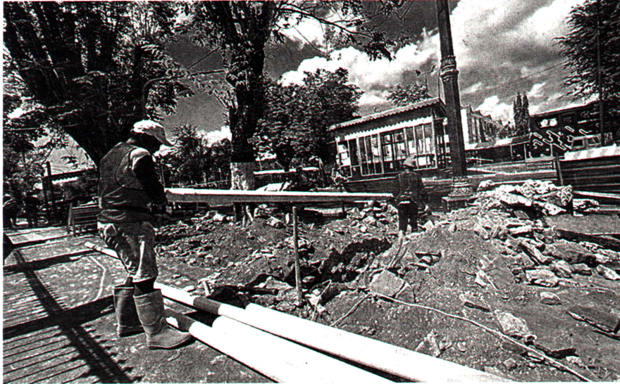
Foto ilustrasi: Pekerjaan revitalisasi pedestrian Jalan Senopati dilakukan sejak akhir Juli dengan anggaran Rp12,2 miliar dan menjadi salah satu dari total 10 proyek strategis Pemkot Jogja pada 2022. Antara/Eka AR
