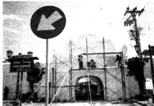
PERCANTIK: Para pekerja sedang mengecat bangunan cagar budaya Plengkung Tarunasura di Wijilan, Di Yogyakarta, beberapa waktu lalu.
