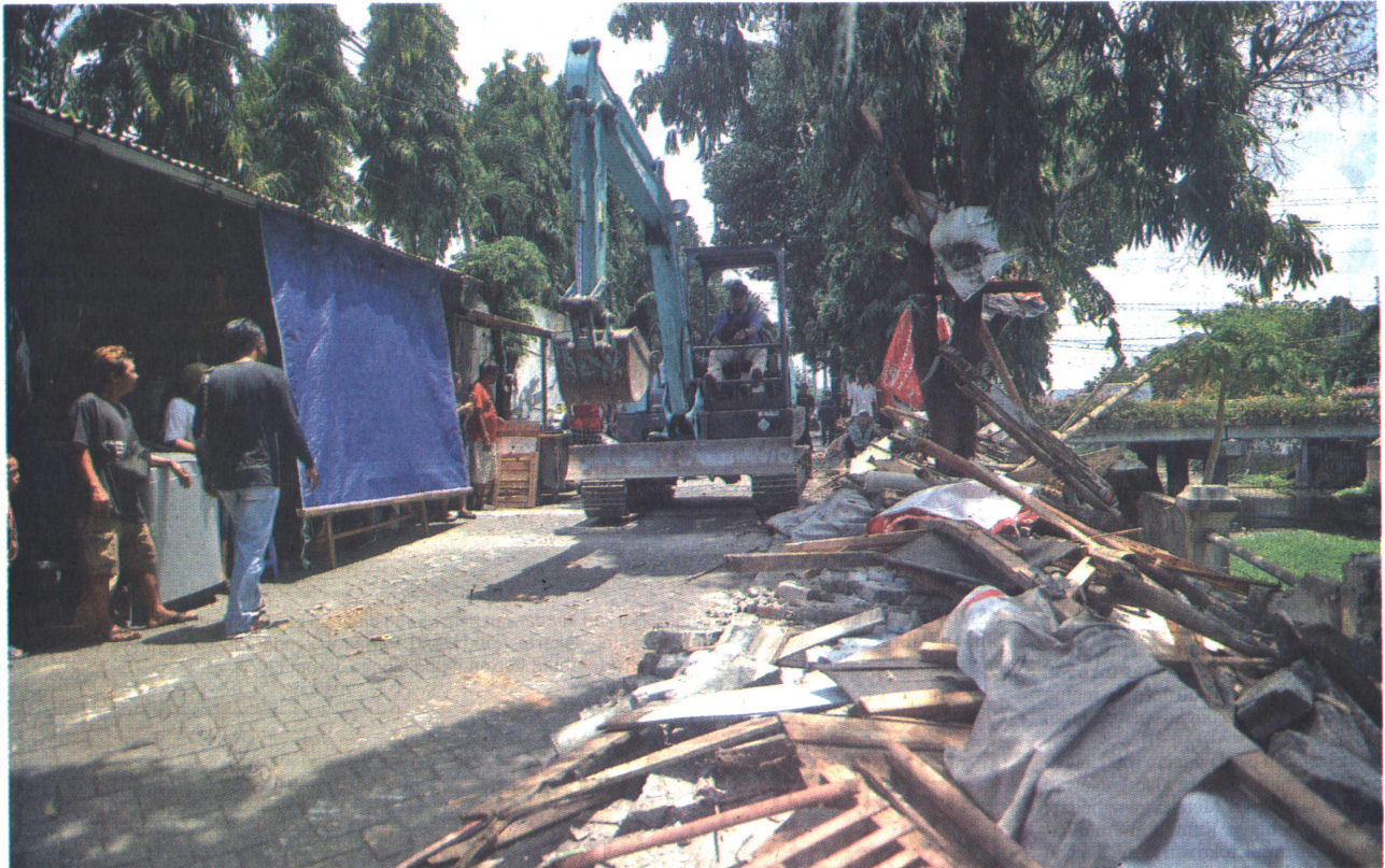
PEMBONGKARAN BANGUNAN DI SEMPADAN SUNGAI Alat berat membongkar bangunan tanpa izin di sempadan Sungai Code, Mergangsan, Yogyakarta, Rabu (28/9). Balai Besar Wilayah Sungai (BBWS) Serayu Opak akhirnya menertibkan bangunan tanpa izin di sempadan Sungai Code. Menurut peraturan bahwa area sempadan sungai merupakan area terlarang untuk mendirikan bangunan. Jumlah sisa bangunan yang dibongkar sebanyak 8 bangunan.
