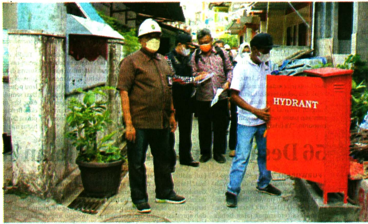
DIPASANG: Hydrant kering disiapkan Pemkot Jogja di Kampung Notoprajan, Ngampilan untuk membantu proses pemadaman api yang sulit diakses.
