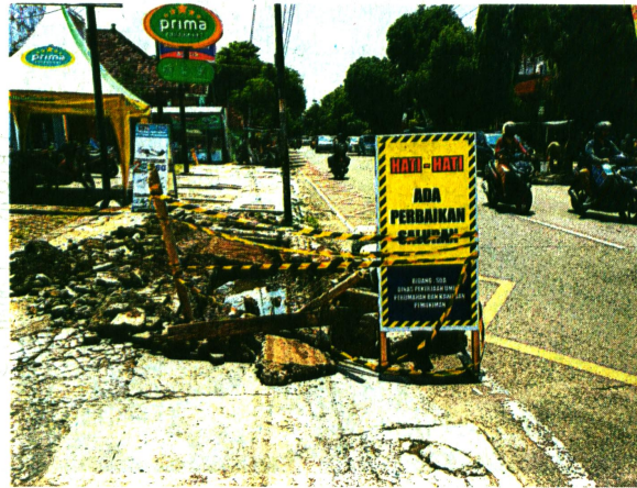
TRIBUN JOGJA/CHRISTI MAHATMA WARDHANI PERLU DIPERBAIKI - Saluran drainase di Jalan Hayam Wuruk Kota Yogyakarta rusak akibat dilintasi truk muatan, Kamis (31/3).
