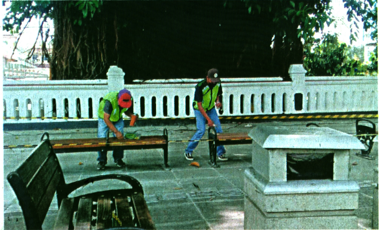
Pekerja sedang memperbaiki kursi di depan Gedung DPRD DIY sebagai bagian dari penataan kawasan semi pedestrian Malioboro, Yogyakarta, Kamis (17/2).
