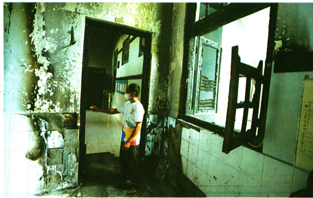
BEKAS KEBAKARAN: Pegawai sekolah menunjukkan bekas kebakaran di SDN Lempuyangwangi, Tegalpanggung, Durejan, Jogja, kemarin (16/1). Kebakaran terjadi Sabtu malam (15/1) akibat hubungan arus pendek kabel proyektor di dalam gedung kelas. Api berhasil dipadamkan dalam waktu satu jam kemudian.
