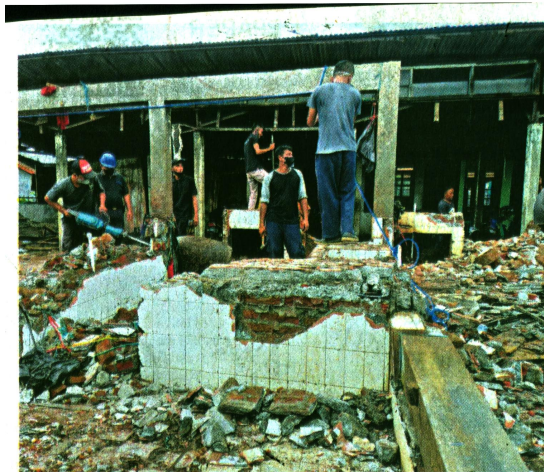
Proses normalisasi kawasan di Pasar Terban yang terimbas longsor.
