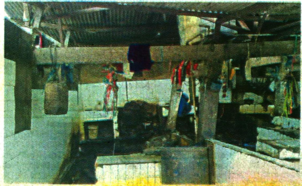
Kondisi kios di Pasar Terban Yogyakarta yang lantainya ambles usai hujan lebat pada Senin (20/12) malam.
