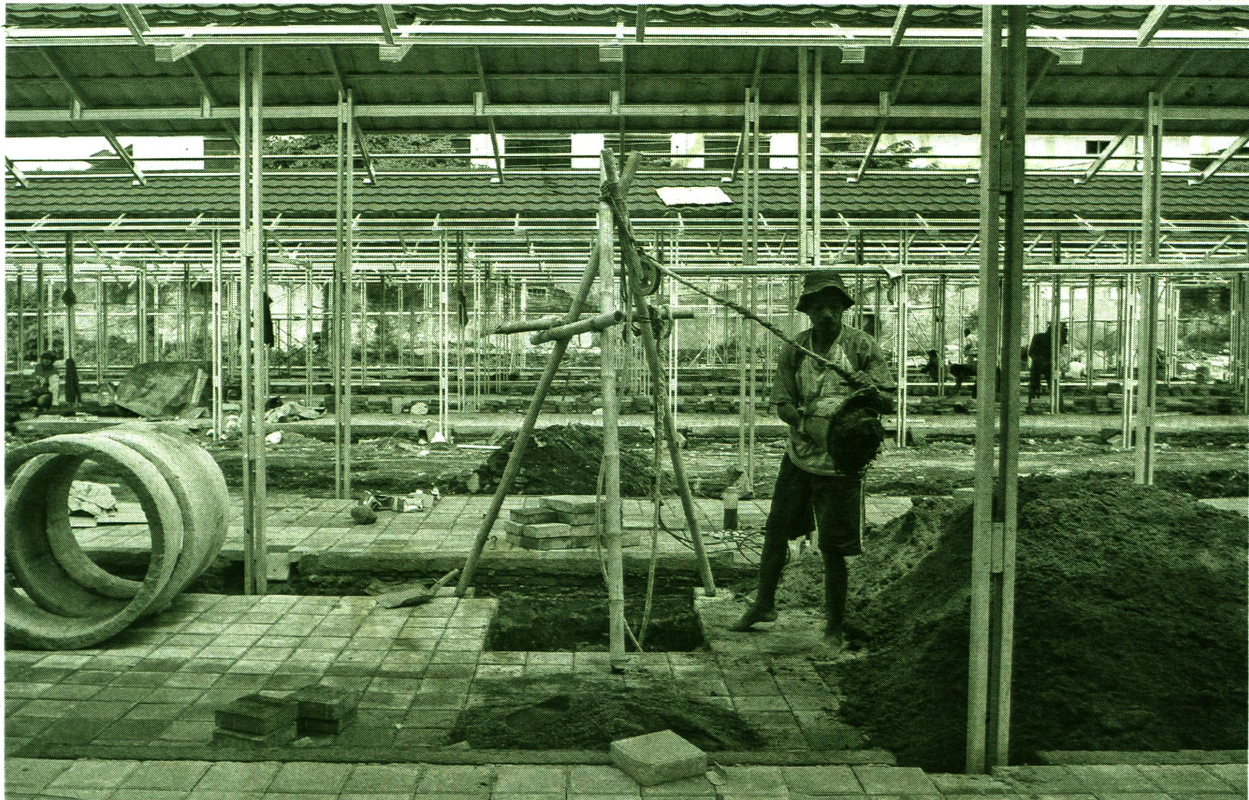
PEMBANGUNAN LOS UNTUK RELOKASI PKL MALIOBORO Pekerja menyelesaikan pembangunan los untuk relokasi pedagang kaki lima di kawasan Malioboro, Yogyakarta, Jumat (10/12). Pemerintah Daerah Istimewa Yogyakarta dan Pemkot Yogyakarta menata kawasan Malioboro dengan membangun dua tempat relokasi di eks Gedung Bioskop Indra dan eks Dinas Pariwisata DIY.
