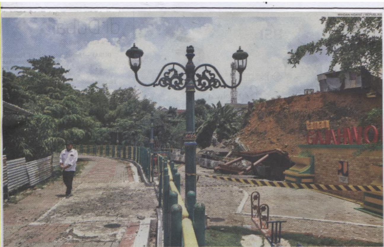
LONGSOR TAMAN GAJAHWONG Taman Gajahwong ditutup sementara imbas tanah longsor di Yogyakarta, Kamis (4/11). Curah hujan yang tinggi beberapa hari terakhir mengakibatkan tanah longsor di samping Taman Gajahwong. Imbasnya Taman Gajahwong sebagian ikut longsor diterjang air yang sungai. Karena jalur aliran air tertutup material longsor. Untuk sementara Taman Gajahwong ditutup untuk aktivitas warga.
