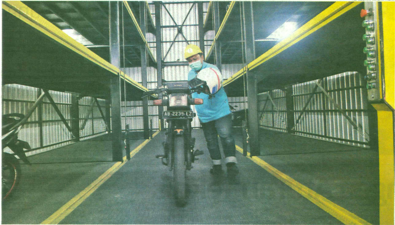
PARKIR MOTOR HIDROLIK PERTAMA DI YOGYAKARTA Operator mengambil motor penyewa jasa parkir di Parkir Motor Bertingkat PKU Muhammadiyah Yogyakarta, Senin (11/10). Parkir motor bertingkat dengan sistem hidrolik ini merupakan yang pertama di Yogyakarta. Tempat parkir khusus motor ini memiliki daya tampung 300 motor dengan delapan lantai. Tarif parkir yang dikenakan sangat terjangkau Rp 2.000 untuk satu jam pertama dan Rp 500 untuk setiap jam selanjutnya dengan batas maksimal Rp 5.000.
