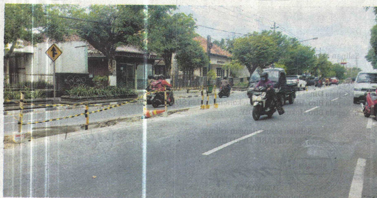
TAK HEMAT ANGGARAN: Jalan Kusumanegara berlubang akibat tengah dibangun saluran pipa PDAM Tirta Marta Kota Jogja. Padahal pengaspalan jalan oleh Dinas PUPKP Kota Jogja baru berjalan kurang dari dua tahun.
