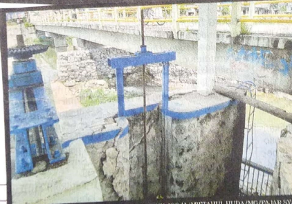
TRIBUN JOGJA/MIFTAHUL HUDA/MG/PAJAR SYAFI RUSAK - Dam Mergangsan, Kota Yogyakarta, mengalami keretakan sejak beberapa tahun lalu. Perbaikan akan dilakukan tahun ini. Foto diambil Selasa (2/2) dan Jumat (5/2).
