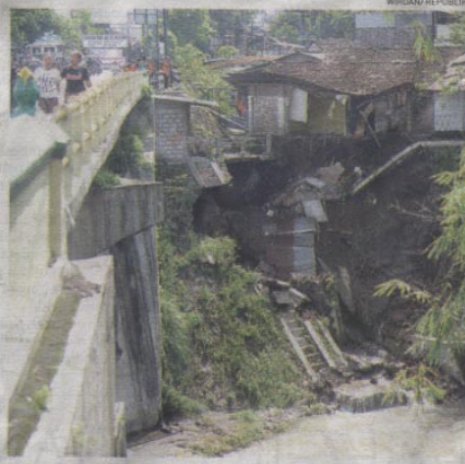
TALUT SUNGAI AMBROL Talut Sungai Winongo ambrol di kawasan Jlagran, Yogyakarta, Kamis (12/3). Talut Sungai Winongo dengan ketinggian sekitar 20 meter ambrol pascahujan deras pada Rabu (11/3) sore. Satu keluarga yang tinggal di tepi talud itu terpaksa mengungsi. Namun tidak ada korban jiwa dalam peristiwa tersebut.
