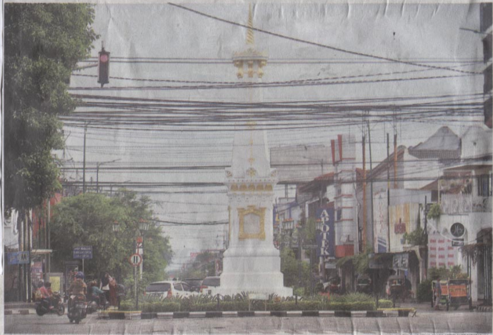
SEMRAWUT: Kabel listrik dan kabel fiber optik yang melintang menghiasi kawasan Tugu Jogja (26/1). Kawasan Tugu yang menjadi bagian sumbu filosofi itu ditargetkan terbebas dari kabel atas akhir tahun ini, terutama hingga radius 100 meter.
