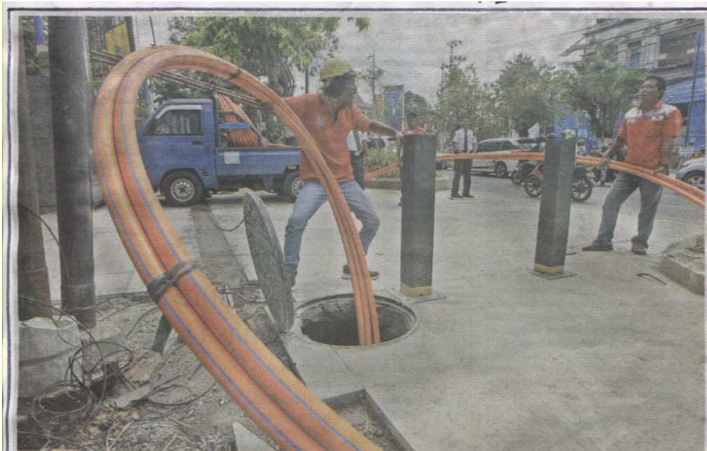
LEBIH RAPI: Pekerja memasukkan pembungkus kabel fiber optik (FO) menuju saluran bawah tanah di kawasan pedestrian Jalan Sudirman, Jogja, kemarin (9/12).
