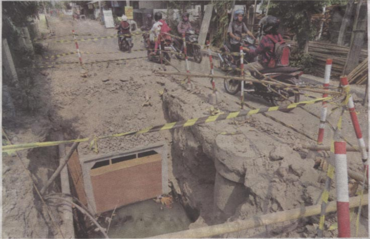
BAHAYA: Lubang menganga di ruas jalan Supomo kini menjadi kubangan air dan tempat nyamuk berkembang biak.
