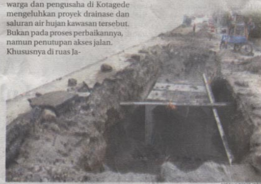
TANAM BETON: Proyek drainase saluran air hujan yang berada di tepat di sepanjang Jalan Mondorakan, Kotagede.
