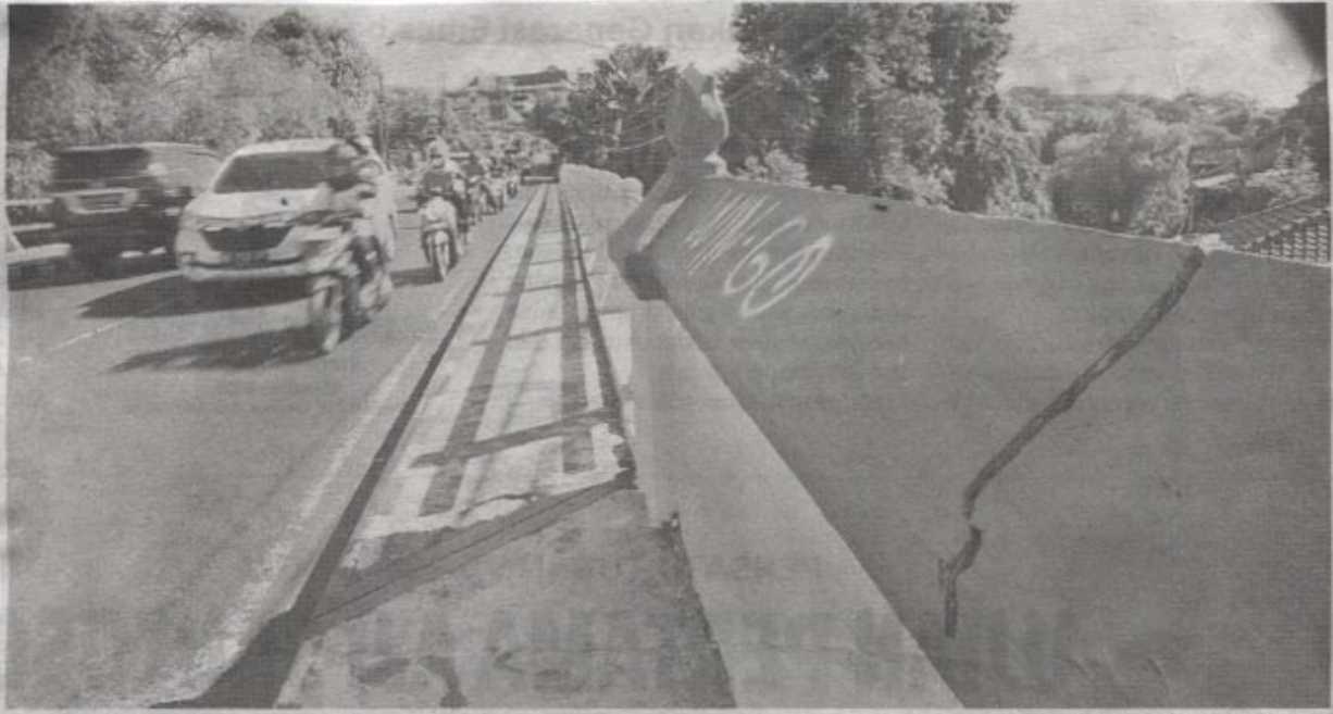
RETAK: Jembatan di Jalan Pembela Tanah Air di daerah Jlagran yang mengalami keretakan. Dinas PUPKP Kota Jogja rencananya baru akan melakukan perbaikan pada Agustus nanti. Tapi kondisi jembatan masih layak dilewati.
