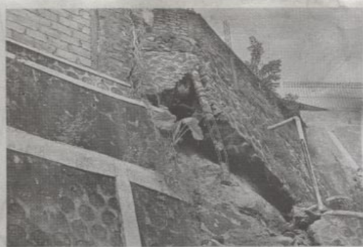
AWAS : Talud pemukiman di RT 45 RW 12 Sudagaran Tegalrejo terancam longsor dan merusak jalan inspeksi serta mengancam dua rumah warga.
