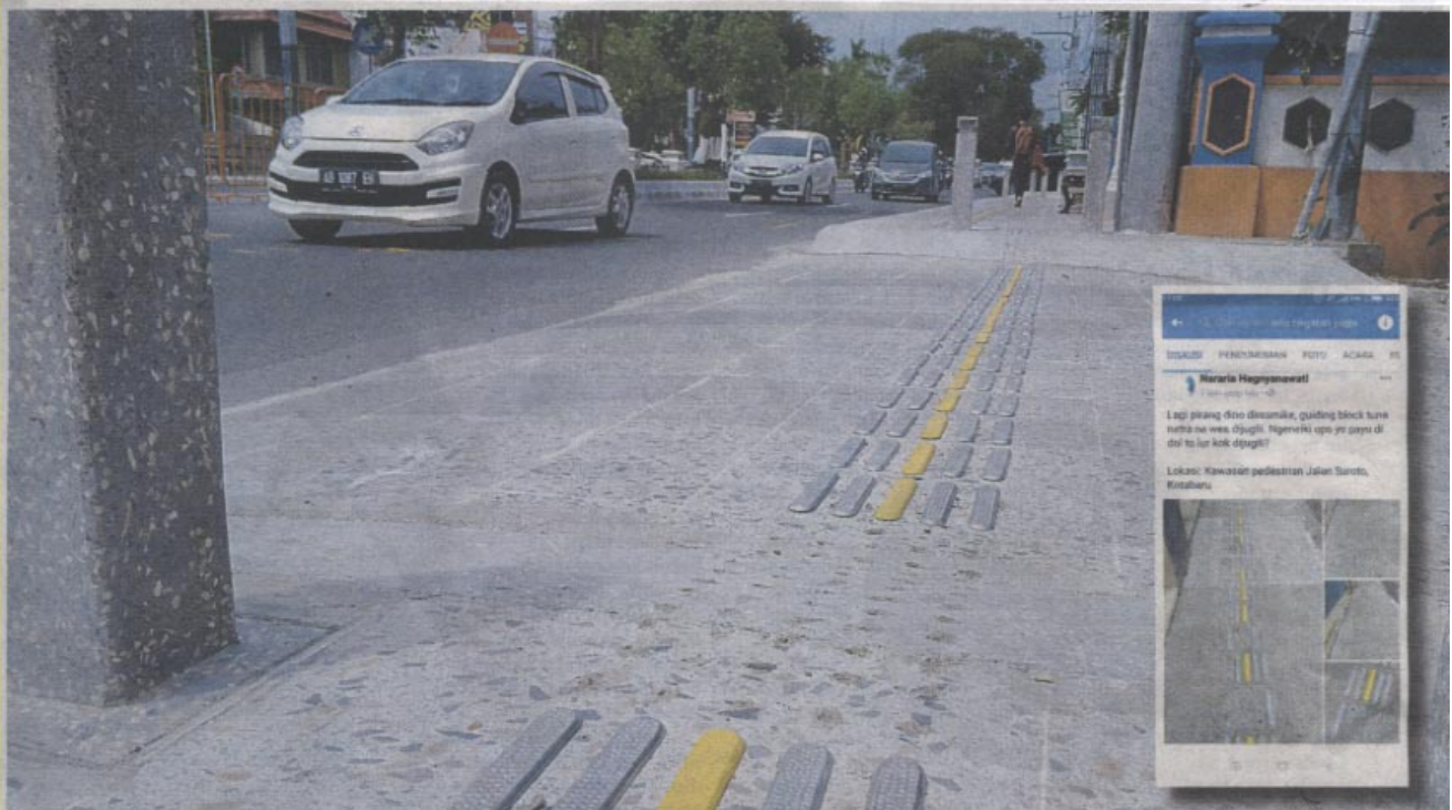
TRIBUN JOGJA/KURNIATUL HIDAYAH/IST-NARARIA HAGNYANAWATI RAIB - Komponen guiding block area pedestrian Suroto di in gang antara kantor Bulog Divre DIY dan kantor Kompas raib, Selasa (1/1). Insert: Kerusakan yang sama di pedestrian sisi barat diunggah warga net.
