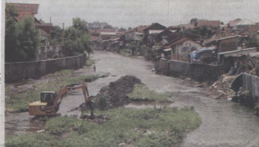
NORMALISASI: Operator backhoe mengeruk endapan lumpur Sungai Code di Kampung Prawirodirjan, Gondomanan, Kota Jogja kemarin (6/12). Sedimen sungai menjadi salah satu pemicu banjir di wilayah itu.
