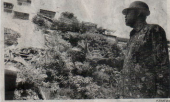
TALUD LONGSOR -- PJ Walikota Yogyakarta, Sulistyono, meninjau lokasi talud longsor, Kamis (9/3). Dia mengatakan A talud longsor di Sungai Code tersebut perlu segera ditangani bersama, dengan solusi yang dinilai terbaik untuk semua.
