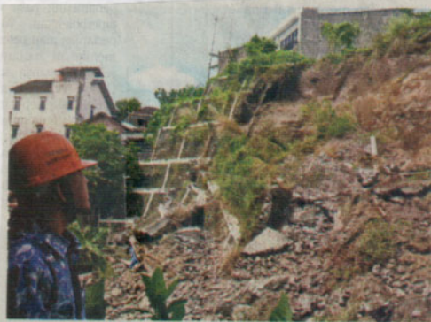
Penjabat Wali Kota Jogja Sulistiyo saat meninjau talut Kali Code yang longsor di Terban, Kamis (9/3) siang.
