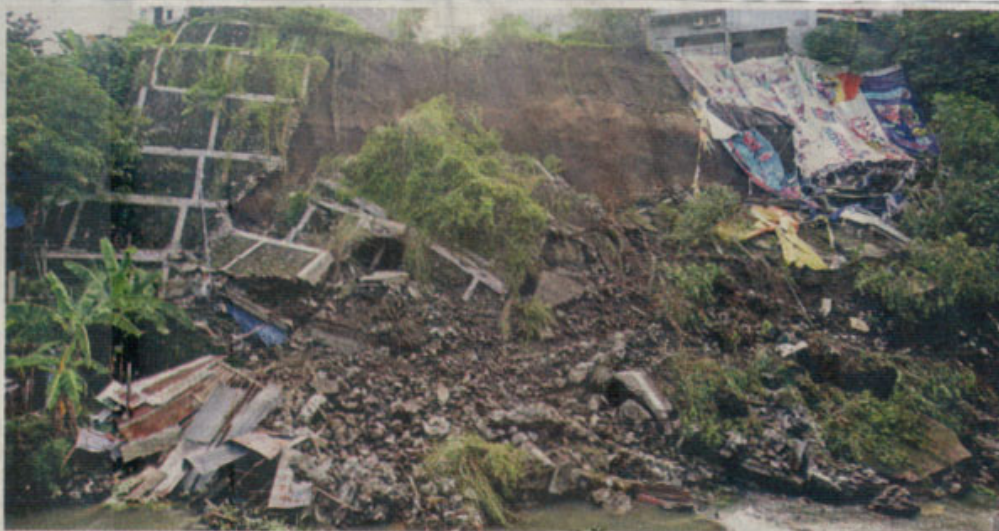
Tebing yang berada di pinggiran Kali code longsor tepatnya di RT02/ RW01 Terban, Gondokusuman, Jogja, Selasa (7/3). Longsor terjadi pada Senin (6/3) kemarin.
